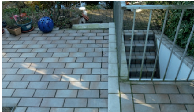
Terrassen und Kellerabgang: Fliesenablösungen an der kleinen Treppenanlage zur Terrasse
